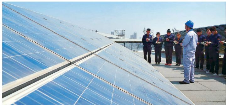
学院屋顶光伏发电系统
